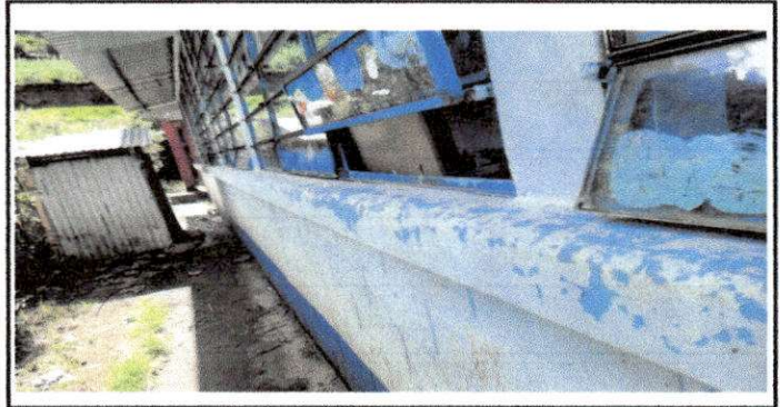
Foto 6: Pintura en muros exterior.
