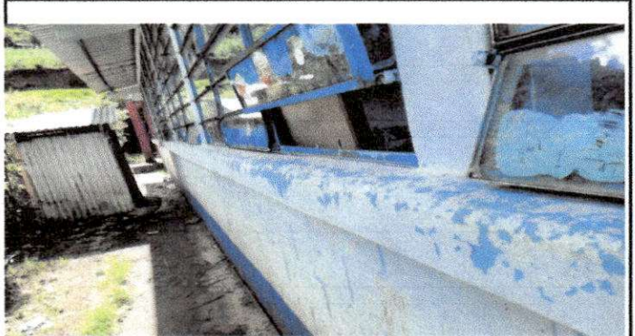
Foto 4: Ventanas en mal estado, sustitución de vidrios.
